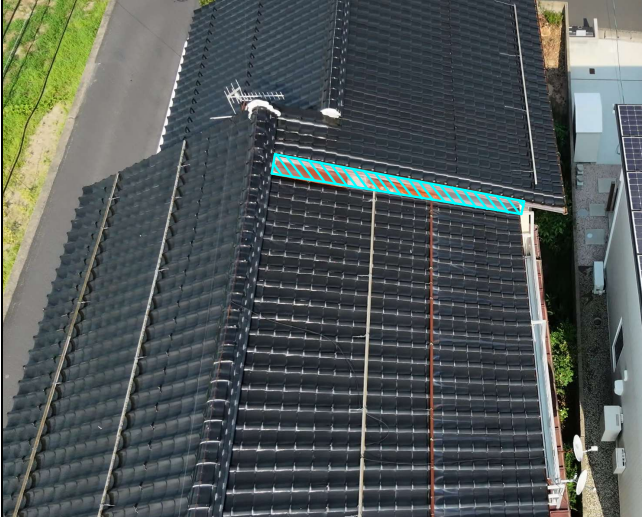
鋼板の腐食の確認
